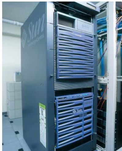
Sun Fire 4800(上) / Sun Fire E2900(下)
